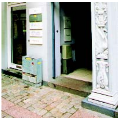
Tilfældig placering. Et skab i portrum og et udenfor. Begge skabe burde være placeret i port, bag fælles afdækning.
