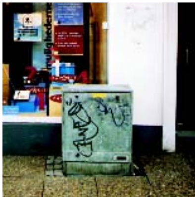
Strøget: Kabelskab som søges fjernet.
