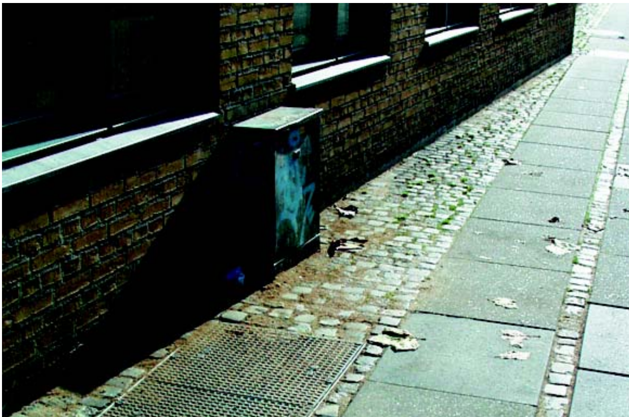
Kontrasten mellem en diskret placering af teknik under terræn contra det traditionelle kabelskab.
