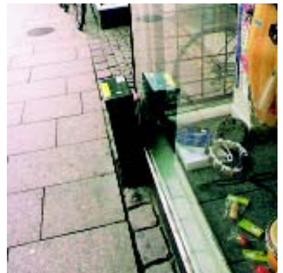
Store Torv: Kabelskab som søges fjernet.
